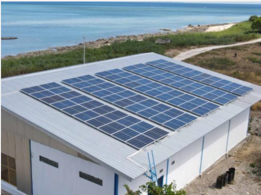
PLTS Atap Sulamu (25 kWp) yang dimanfaatkan sebagai sumber listrik mesin pembuat es di Kupang
